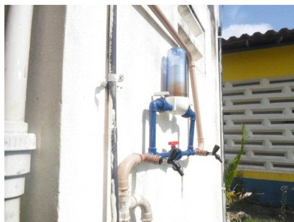
Figura 2. Dosador de cloro no SAC do Hospital Municipal de Santa Helena (2015).
